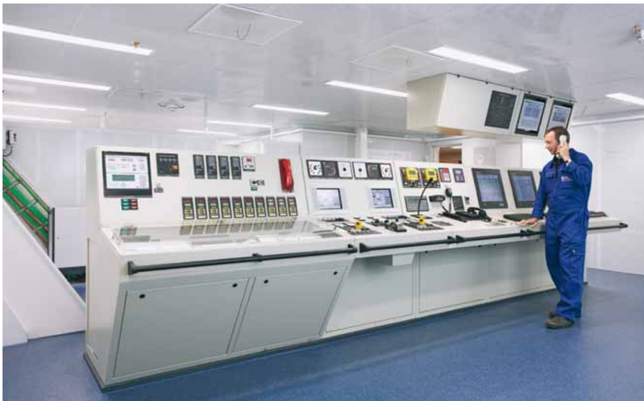
Maschinenkontrollraum eines Fährschiffes
